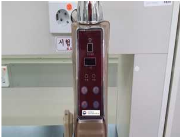
[전원 ON/OFF 제어기 정상동작 확인]
